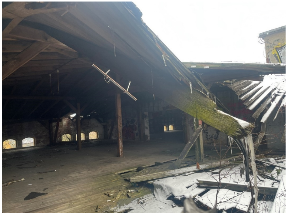
Foto 2: Dacheinsturz auf Gebäudeteil 5.5
