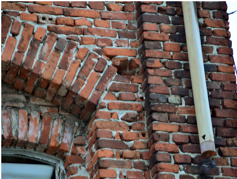
Foto 10: Fehlstellen und Langlochziegel an der Süd-West-Ecke des Gebäudeteils 5.5
