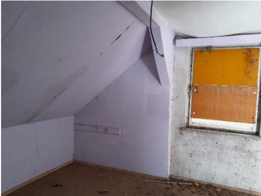
Foto 5: Blick in ein Zimmer im Obergeschoss. Das Fenster ist ebenfalls nicht voll verschlossen.
