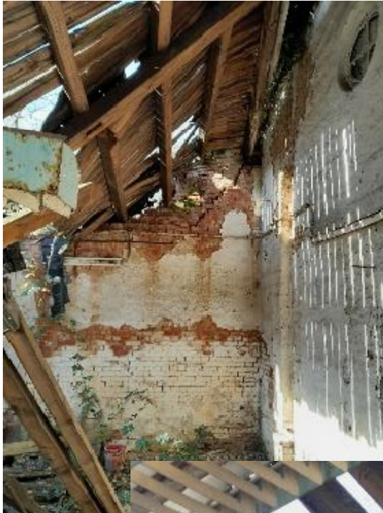
Foto 19+20: Blick in den verfallenen Teil des Gebäudes
